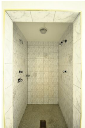
KUNDL - Einfamilienhaus - Dusche/Keller
